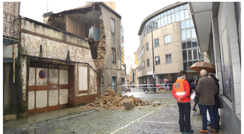
Derrocada de prédio na esquina das ruas Gomes de Amorim e da Vila Velha
